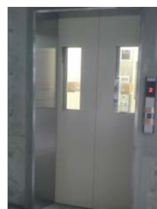
(新設エレベーター)
