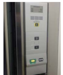
(エレベーター内部)
