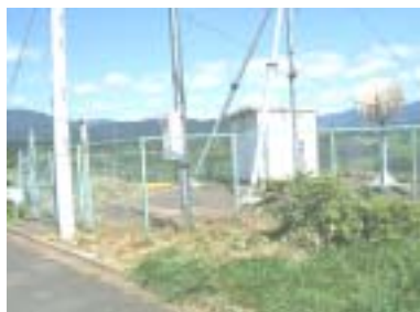
CATV 受信設備まわり
